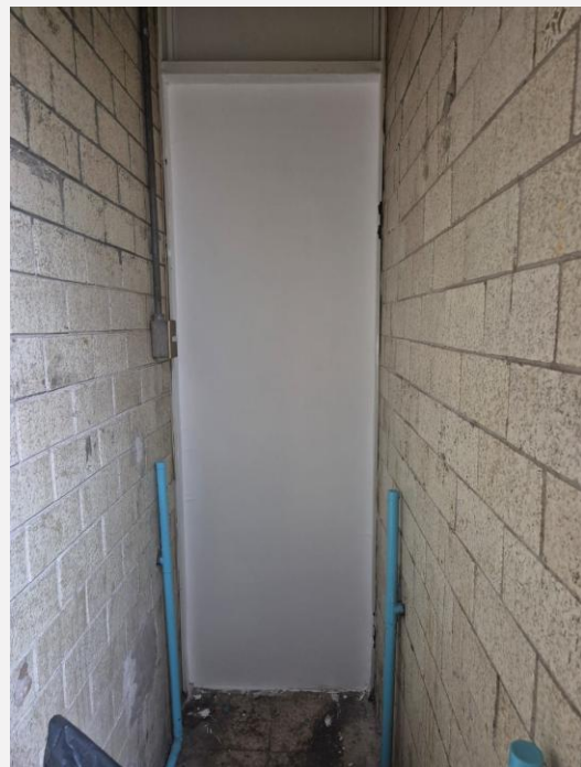
Ductos de planta tercer nivel
