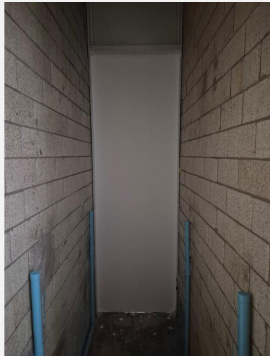
Ductos de planta segundo nivel
