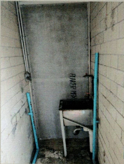
Ducto planta baja
